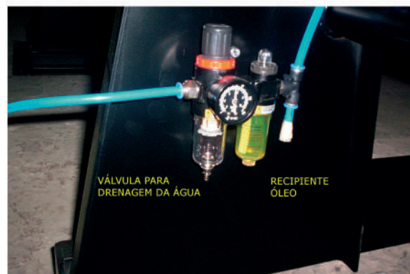
(FOTO 4: FILTRO LUBRIFIL)
